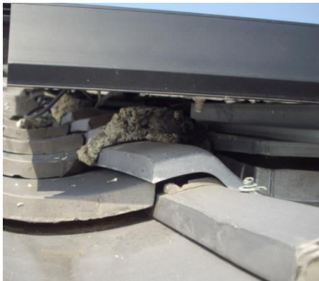
太陽電池モジュールを設置するための支持瓦と周辺瓦の大きさが異なっているため、大きな隙間から瓦内部へ雨水が浸入した例
