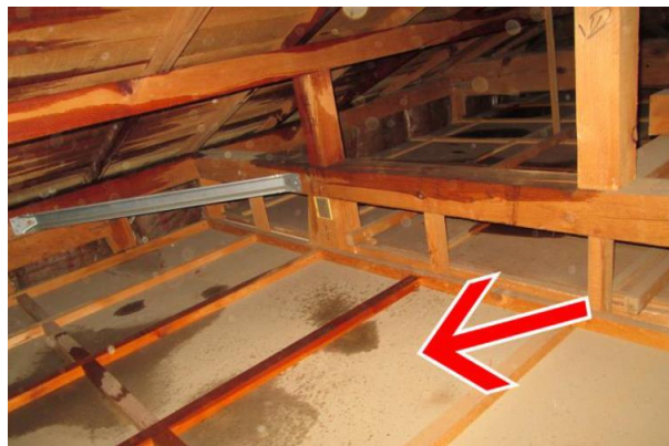
雨漏りをおこした野地板の例
